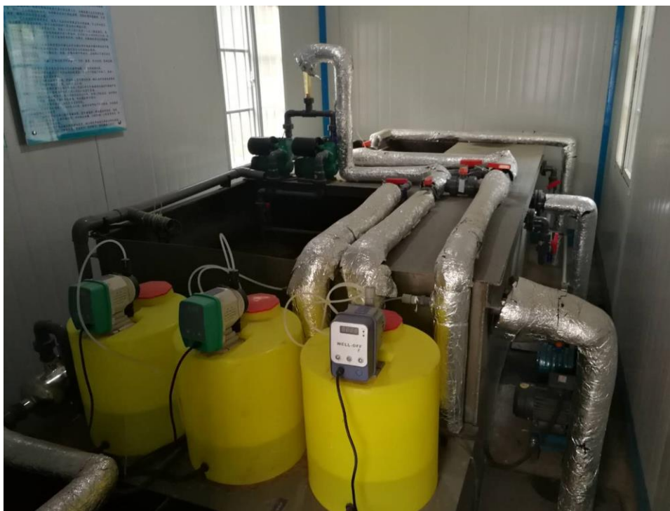
图 9 污水处理设备操作间
